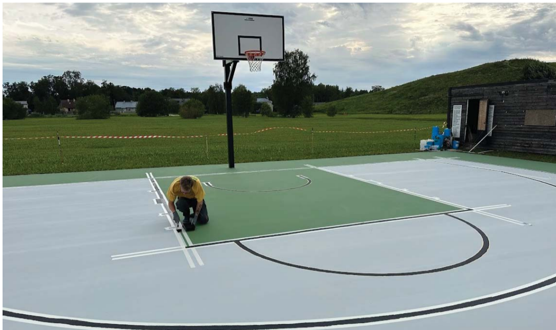
Tolmavad või katkise asfaltkattega platsid asenduvad akrüüliliga kaetud betooniga väljakutega. Foto: Betooneistrid
