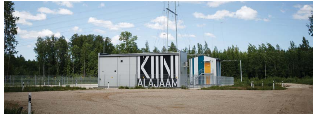
Kiini alajaam – 2019. aasta parim elektrivõrgu ehitusobjekt piirkonna- ja jaotusalajaamade kategoorias. Foto: Karl-Erik Kumm / Elektrilevi
