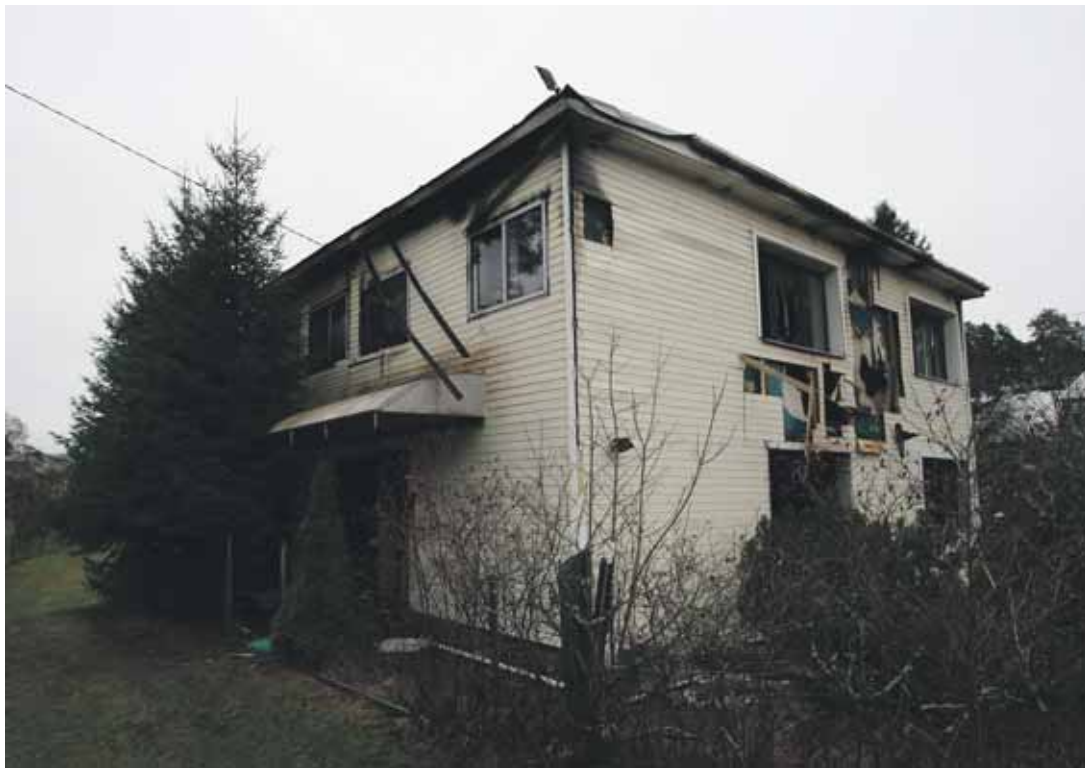
Tulekahju tagajärjel sai elamu suuri kahjustusi.
