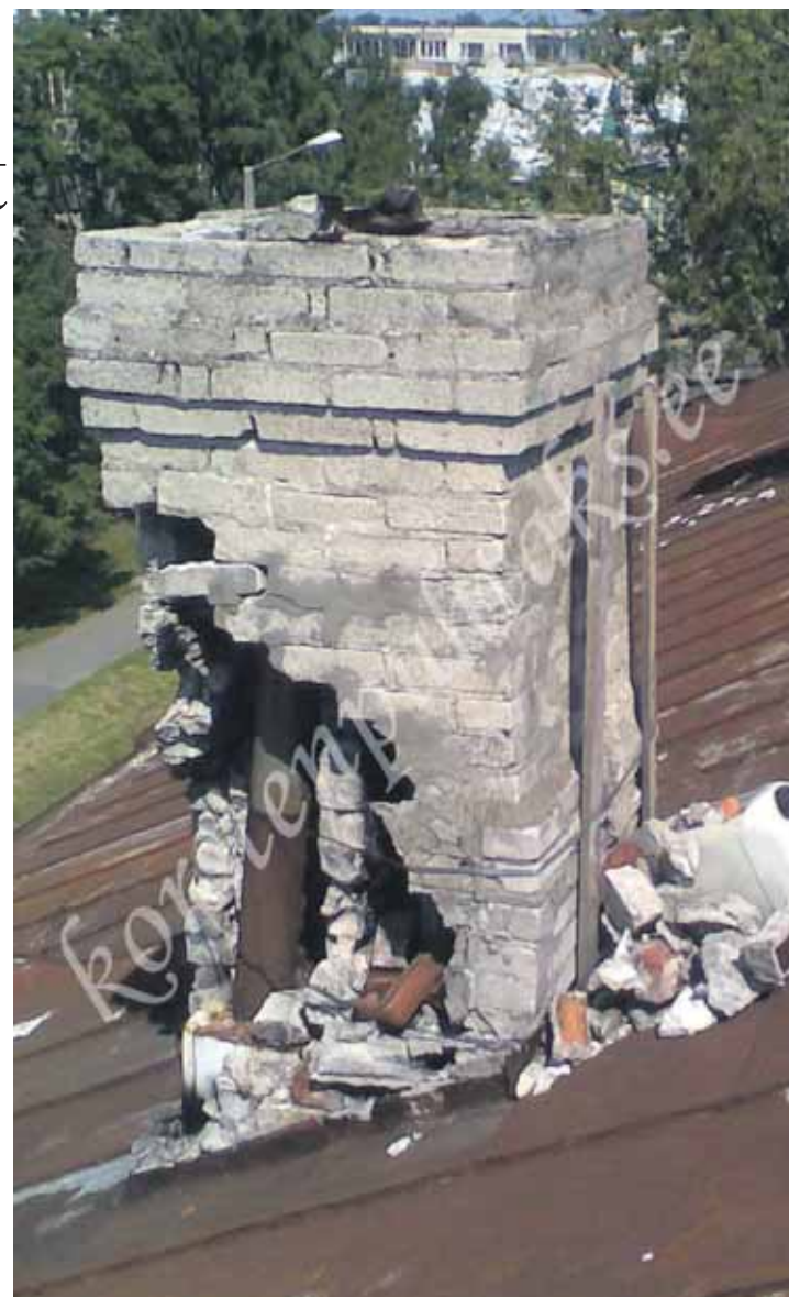
Pahatihti kohtab majade katustel väga lagunenu korstnaid, mis on ohtlikud juba ka möödaajajatele. Foto: www.korstenpuhtaks.ee
